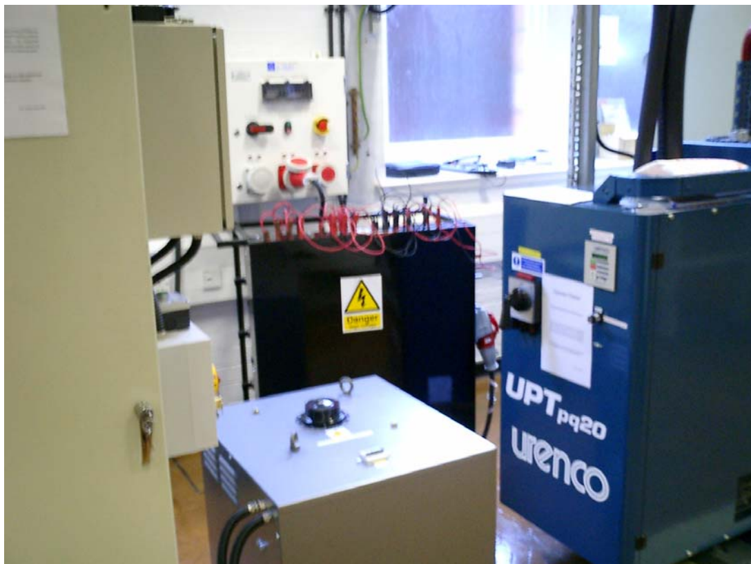
Fig. 59: 12kW load bank
