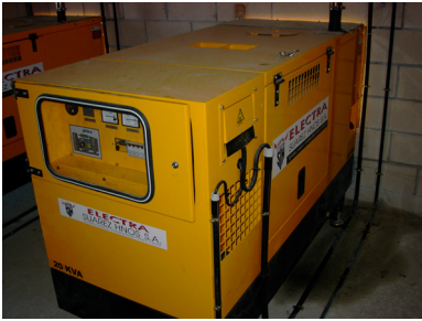
Fig. 5c: 20 kVA diesel gen set
